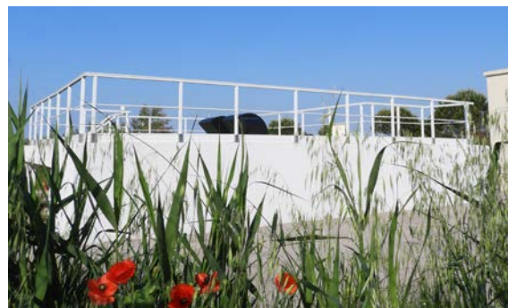
Le nouveau poste de refoulement sous pression d'air à Saint-Laurent d'Aigouze
