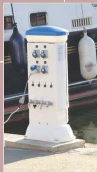
Equipement de bornes électriques
