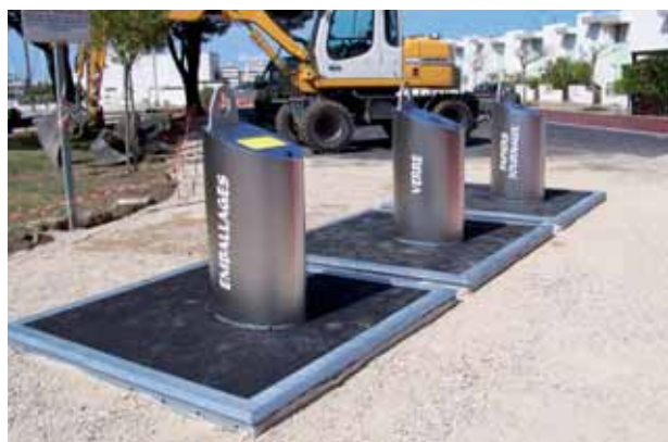
Pour le tri sélectif, les containers enterrés.
