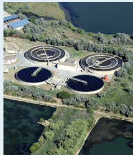
La station d'épuration biologique au Grau du Roi
