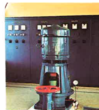
Intérieur de la station
